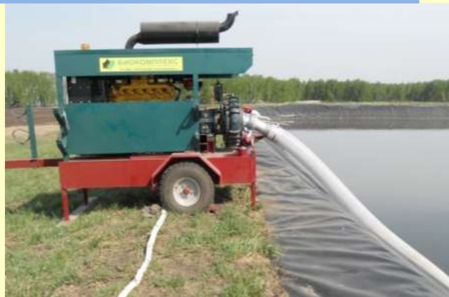
Станция для перекачивания жидкой фракции
